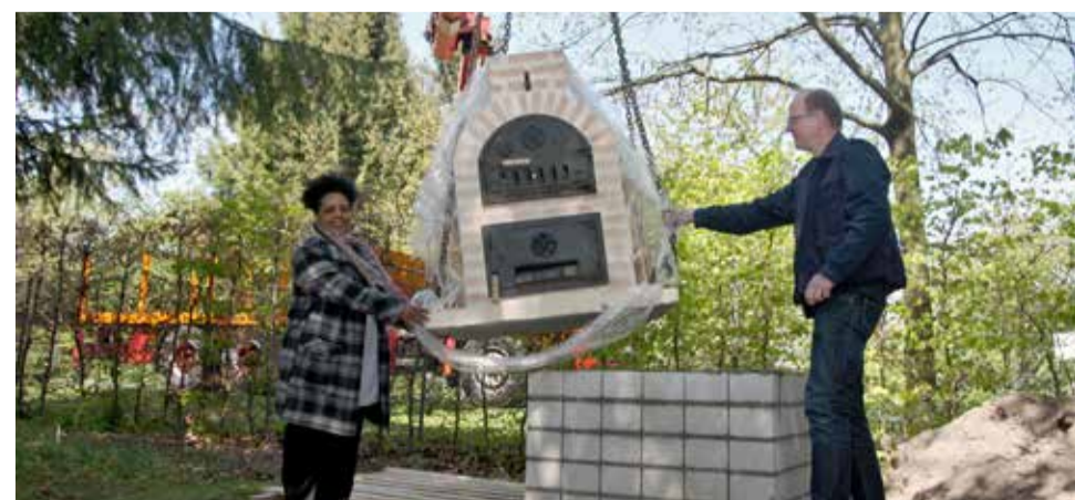
Ein Autokran hebt den schweren Ofen in die Höhe und setzt ihn auf dem Sockel ab.
